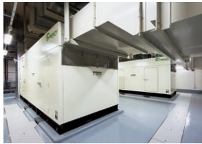
非常用発電機 (ガスタービン)
