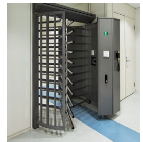
ローターゲート サーバー室への共連れ防止
