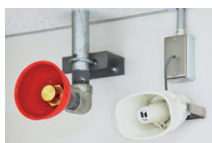
ガス消火システム
